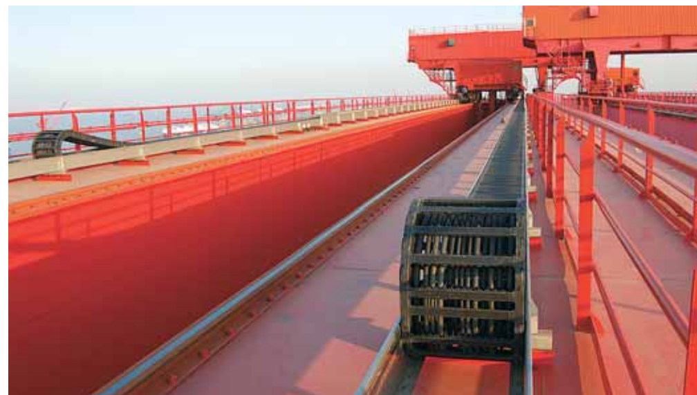
港口起重机: 行程180m, 负载30kg/m。易格斯E4/4轮式拖链自2001年安装完成后, 经历恶劣天气依然运行良好, 甚至经历台风依然无故障运行。
